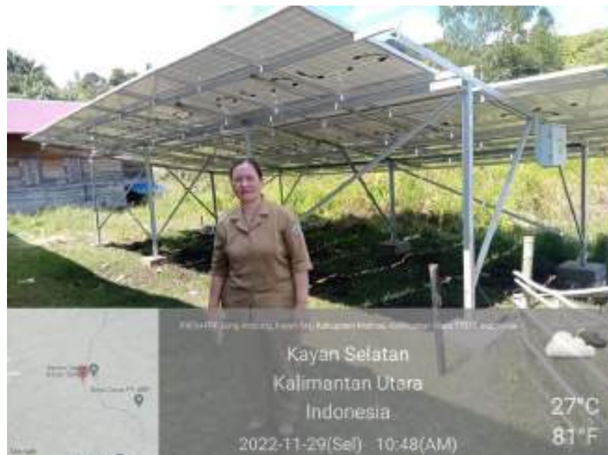
Gambar Penyediaan Prasarana Listrik Puskesmas (Solar Cell) di Puskesmas Perbatasan.
