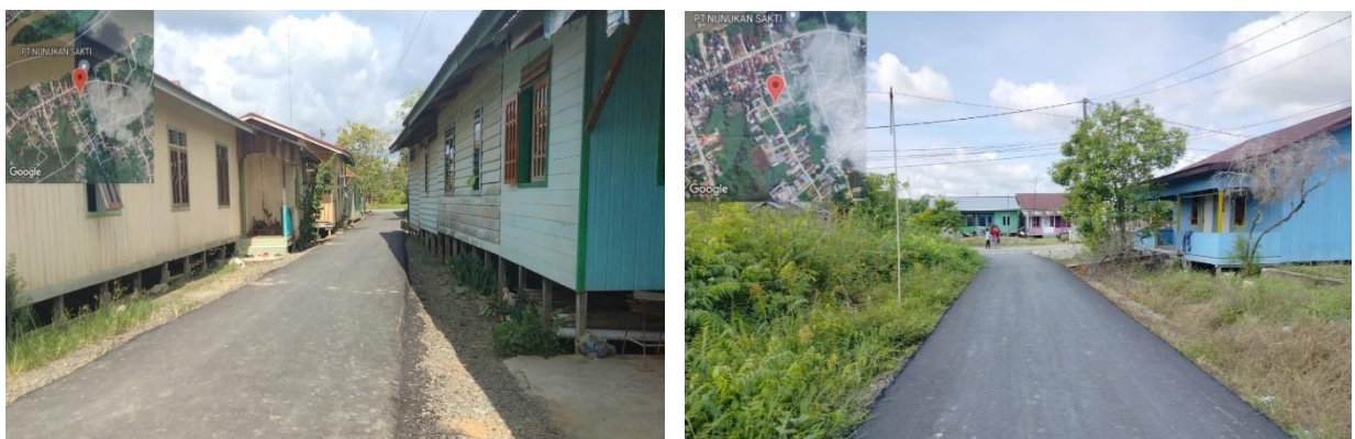
Gambar 3.37 Pemeliharaan Berkala Jalan Kabupaten Malinau
