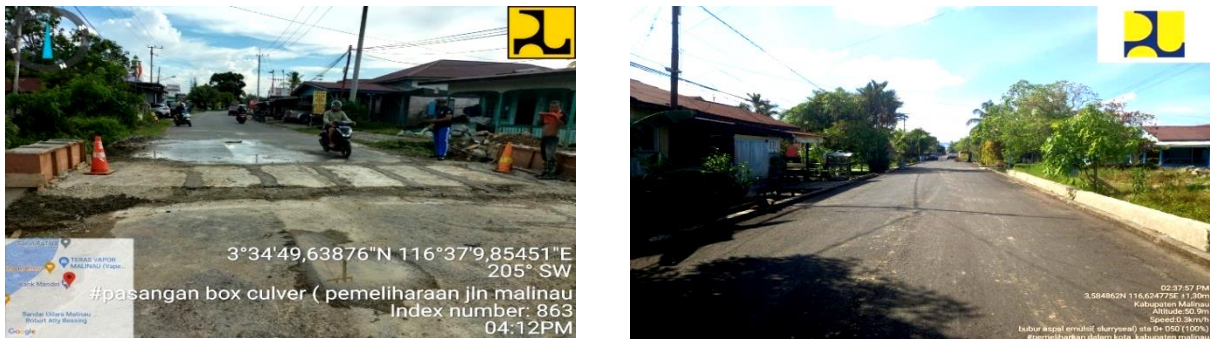
Gambar 3.33 Pemeliharaan Berkala Jalan Kabupaten Malinau
