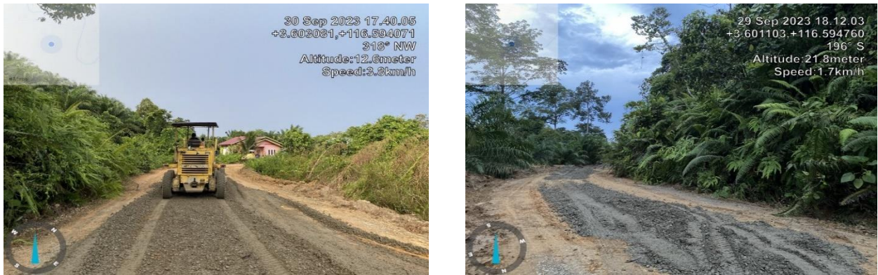
Gambar 3.36 Pemeliharaan Berkala Jalan Kabupaten Malinau
