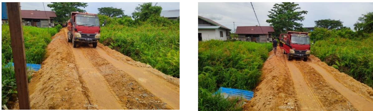
Gambar 3.34 Pemeliharaan Berkala Jalan Kabupaten Malinau
