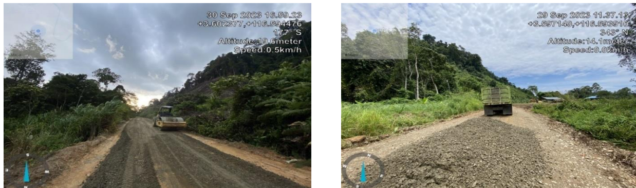
Gambar 3.35 Pemeliharaan Berkala Jalan Kabupaten Malinau
